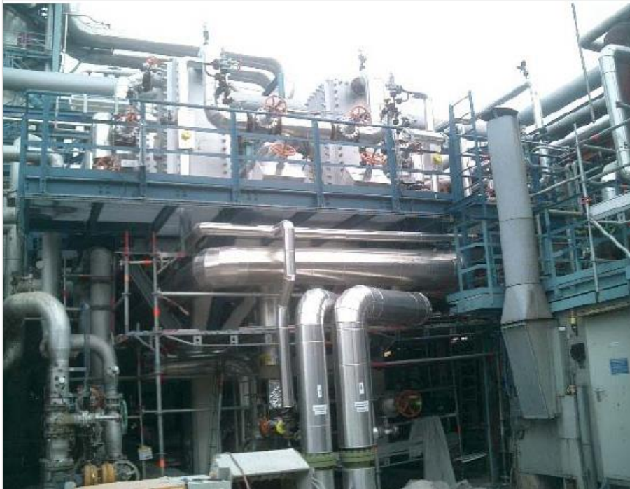
Integration Wärmetauscher bei MiRO
