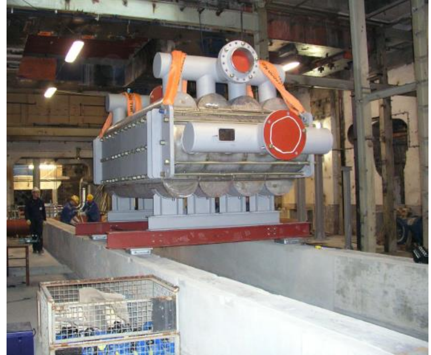
Aufstellung Wärmetauscher im HKW-West
